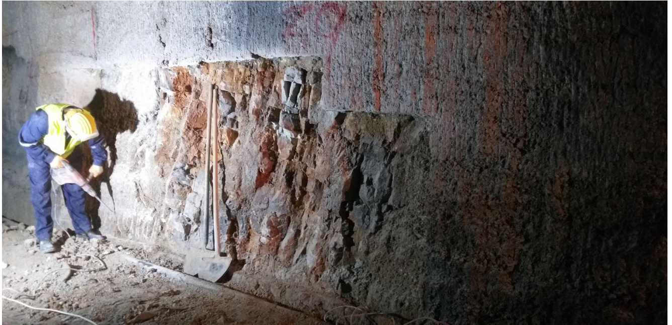
Izrada plombi- sanacija na mjestima lokalno ruiniranog betona i tanke postojeće obloge tunela
